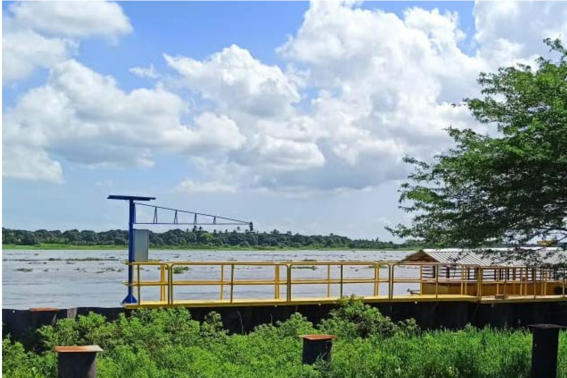
Figura 2. Primera estación automática fluvial de Colombia instalada en el Río Magdalena.
