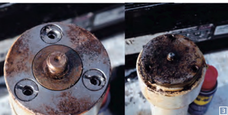
Fig 3. Composición fotográfica del estado de la base nivelante de la antena y retiro de la sección superficial. Fig. 3. Photographic composition of the state of the leveling base of the antenna and removal of the surface section.
