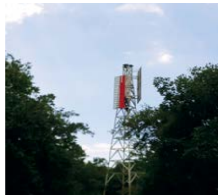
Figura 8. Enfilación antigua E12-E14, la cual se encuentra afectada por el vandalismo y/o hurto de sus componentes estructurales. Fuente Dimar.
