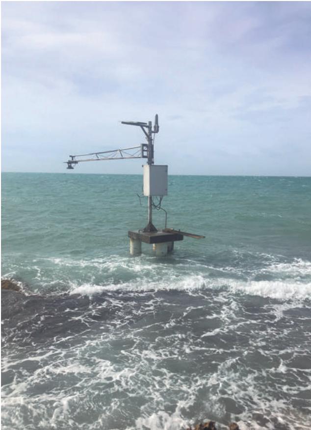
Figura 1. Estación meteorológica automática y mareográfica (EMMA) instalada en Puerto Bolívar (La Guajira).
