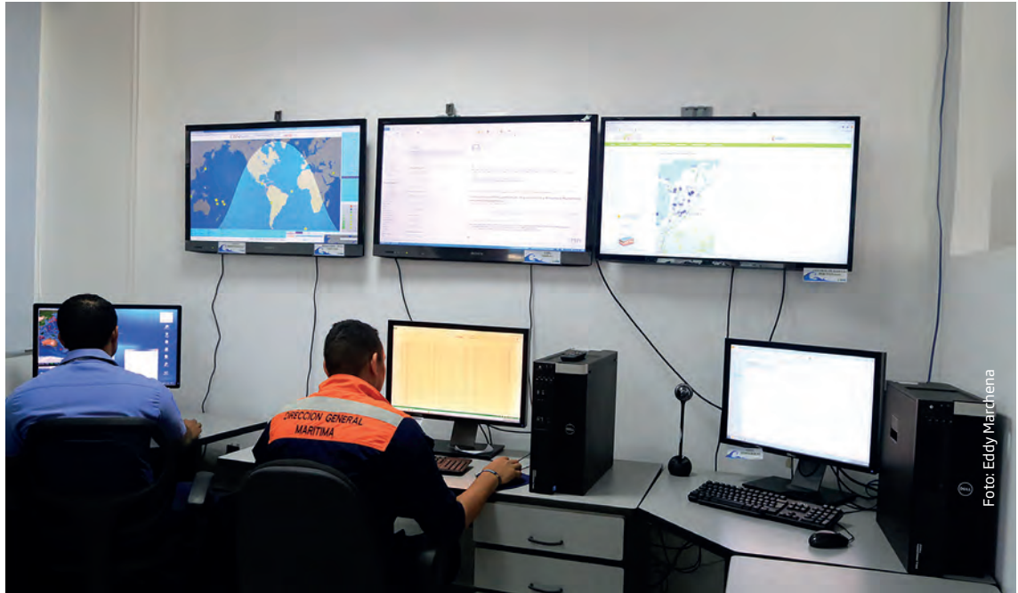
Centro de Alerta Temprana por Tsunami (CAT) que opera en las instalaciones del CCCP.
