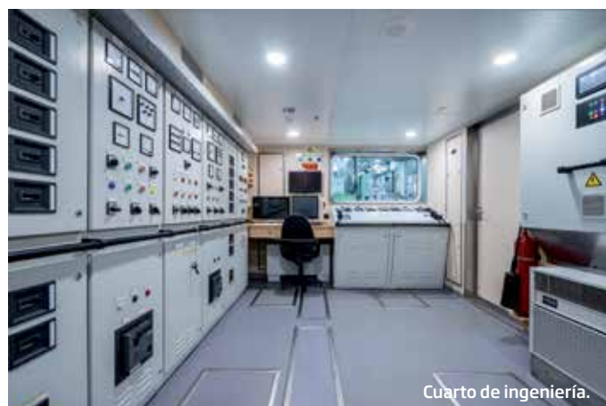
Sistema de Posicionamiento Dinámico DP1.
