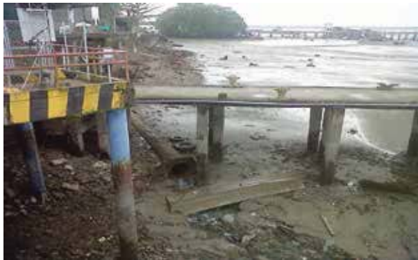
Figura 4.1 Descargas de aguas residuales domésticas hacia el medio marino.
